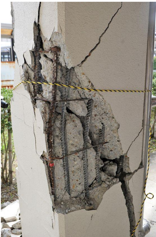
Figura 1 - Corrosão da armadura em um pilar
