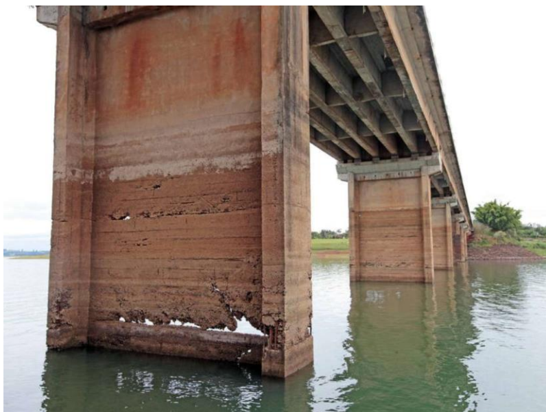
Figura 2 - Fissuras aparentes na estrutura de uma ponte em Raposo/MG
