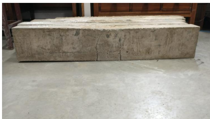
Figura 54 - Fissuração sob carregamento máximo CP 02
