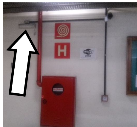
Figura 49 – Iluminação de emergência desligada.
