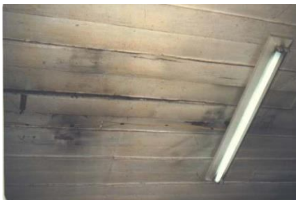
Figura 29 – Curto-circuito de reator forro de madeira
