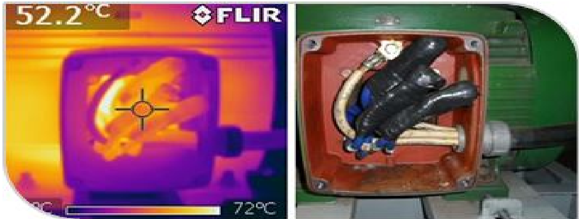
Figura 20 – Verificação em uma caixa de passagem
