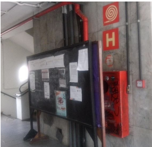
Figura 44 – Caixa de hidrante obstruída
