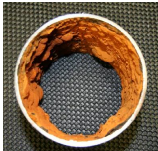
Figura 15 – Obstrução parcial de tubulação de incêndio.
