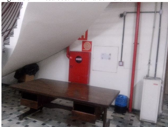
Figura 50 – Mesa obstrui caixa de hidrante
