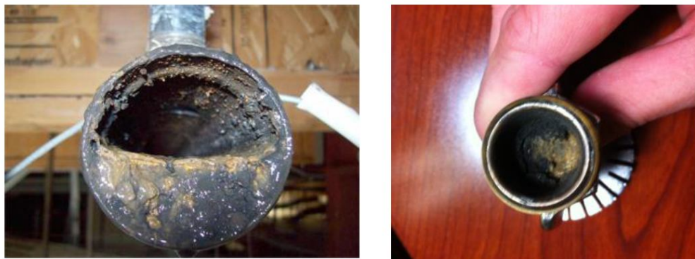
Figura 12 – Tubulação–esq, com incrustações após cinco anos; e sprinkler–dir, após doze anos
