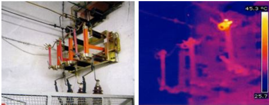
Figura 25 – Excesso de carga em uma das fases
