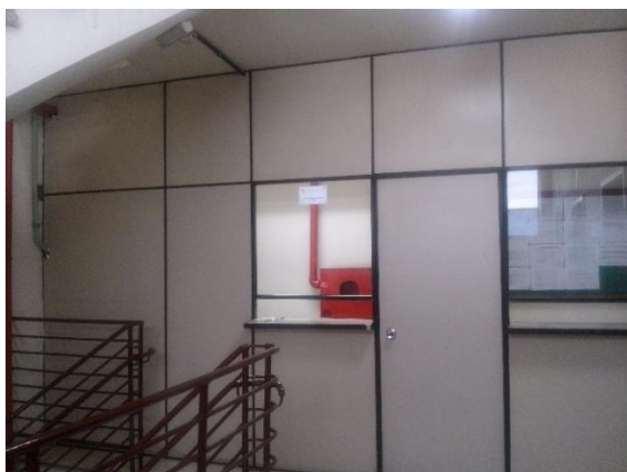
Figura 48 – Restrição de acesso a caixa de incêndio
