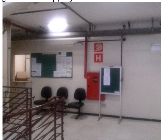
Figura 51 – Recepção junto a caixa de hidrante
