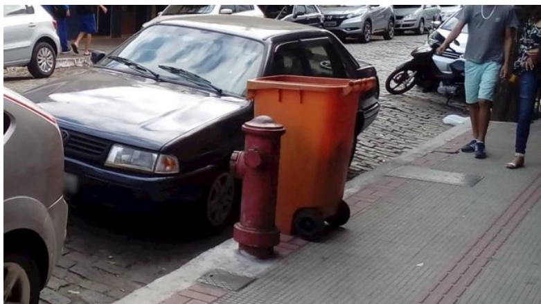
Figura 56 - Hidrante não sinalizado
