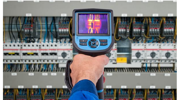
Figura 24 – Verificação em quadro de distribuição
