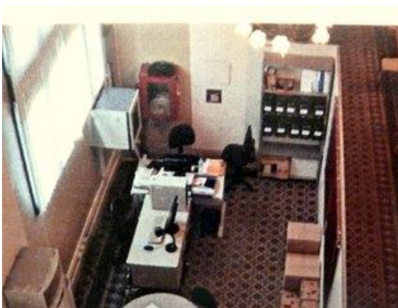
Figura 52 – Escritório em situação irregular (como está, impede o acesso ao hidrante)
