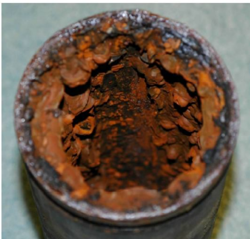
Figura 14 – Obstrução de tubulação com formação de pitting
