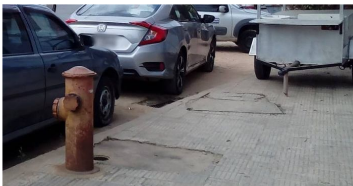
Figura 57 - Falta de demarcação para hidrante e veículo dificultando seu uso
