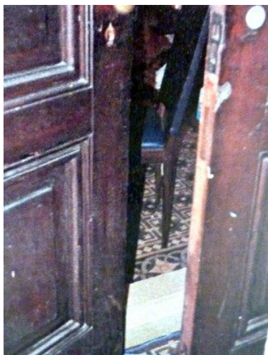
Figura 53 – Porta de rota de fuga impedida de abrir
