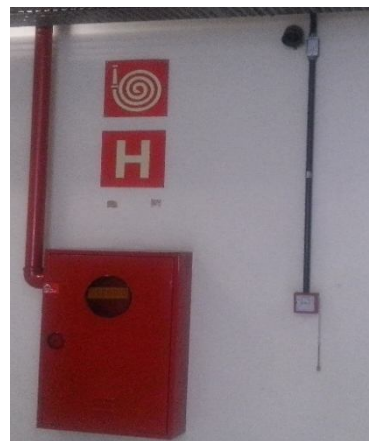
Figura 47 – Ausência de martelo quebra vidro.
