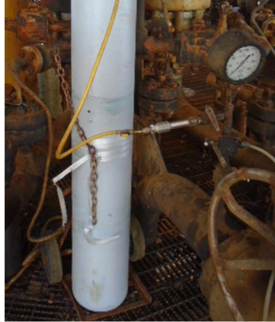
Figura 6: Cilindro de nitrogênio conectado à mesma tomada usada para drenagem do riser , à montante (plataforma-ANM) do ponto de corte
