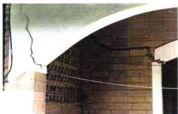
Figura 7 – Fissuras em parede de alvenaria
