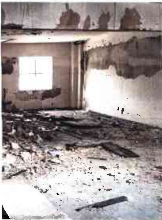
Figura 31 – Destacamento da superfície de pintura interna no 6º pavimento
