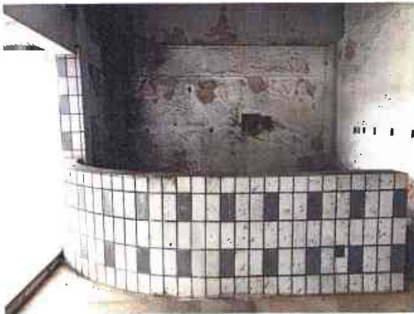
Figura 25 – Espaço destinado a uma possível lanchonete no último pavimento em estado de deterioração por falta de manutenção
