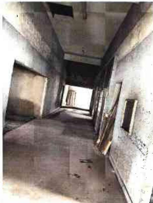
Figura 26 – Hall do último pavimento deteriorado e inacabado
