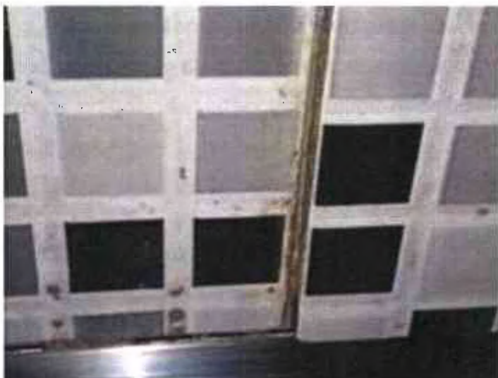
Figura 11 – Infiltrações por rejuntamento ineficiente
