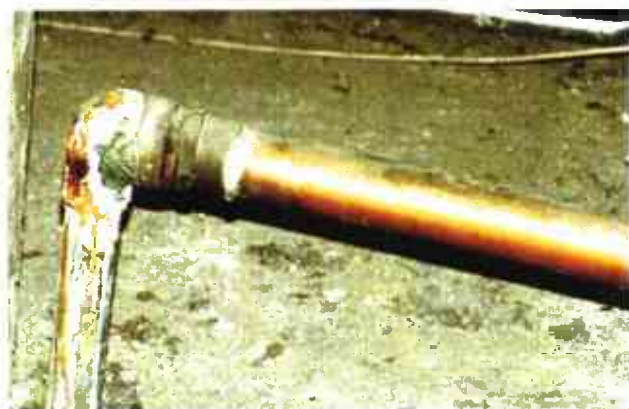
Figura 6 –Tubulação de cobre em processo de corrosão
