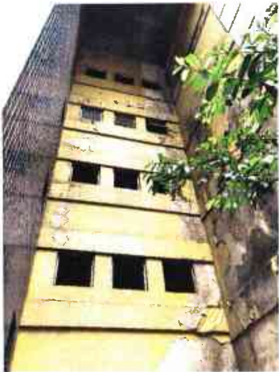
Figura 22 – Detalhe do destacamento da superfície de pintura na fachada do Center Shopping Itabira – vista da Rua Sizenando de Barros em 06/11/2018
