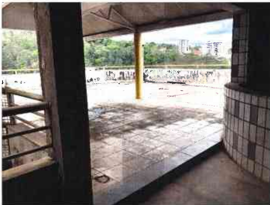
Figura 27 – Área externa do último pavimento deteriorado pelas intempéries
