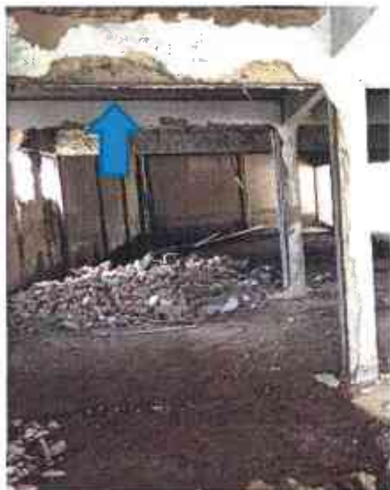
Figura 29 – Destacamento do reboco interno no 7º pavimento
