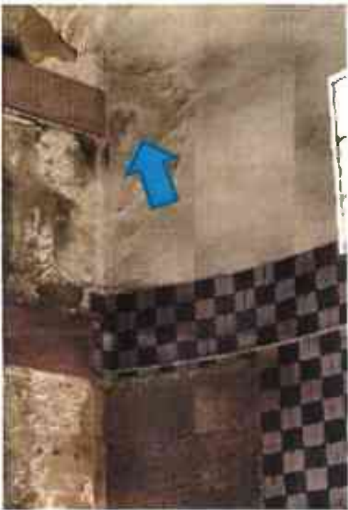
Figura 33 – Parede de divisa com a fachada apresentando indícios de infiltração
