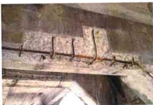
Figura 4 – Viga de concreto armado com armaduras expostas
