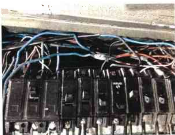
Figura 5 – Quadro elétrico com fiações em desconformidade
