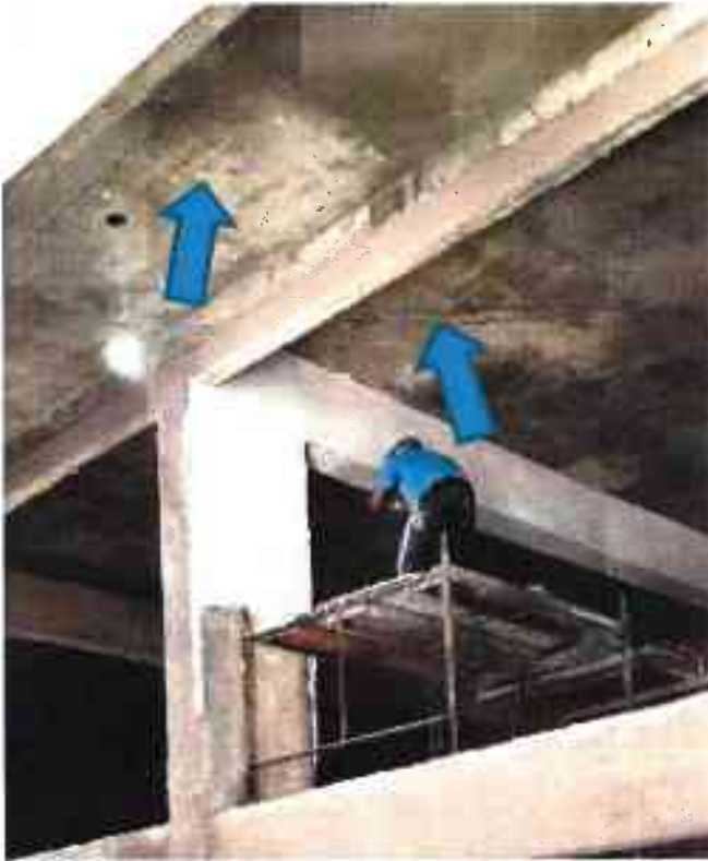
Figura 35 – Laje do 6º pavimento apresentando indícios de eflorescências
