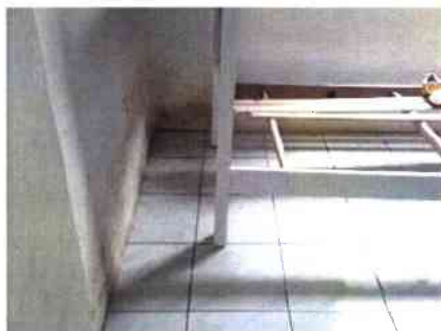
Figura 10 – Infiltrações na alvenaria por impermeabilização ineficiente
