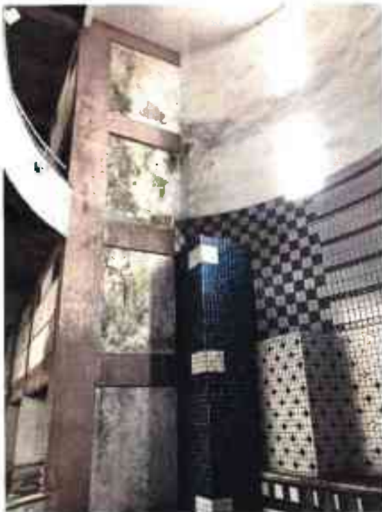
Figura 23 – Detalhe na cascata no hall principal com mofo nas paredes internas do Center Shopping de Itabira em 06/11/2019
